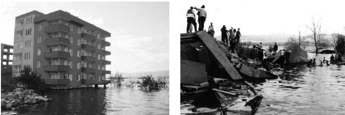
Figura 2.4 Edificio en Gölcük. La fotografía de la izquierda muestra la edificación una vez ocurrido el evento principal y la fotografía de la derecha el colapso de la estructura transcurrido un mes ante la réplica [56]
