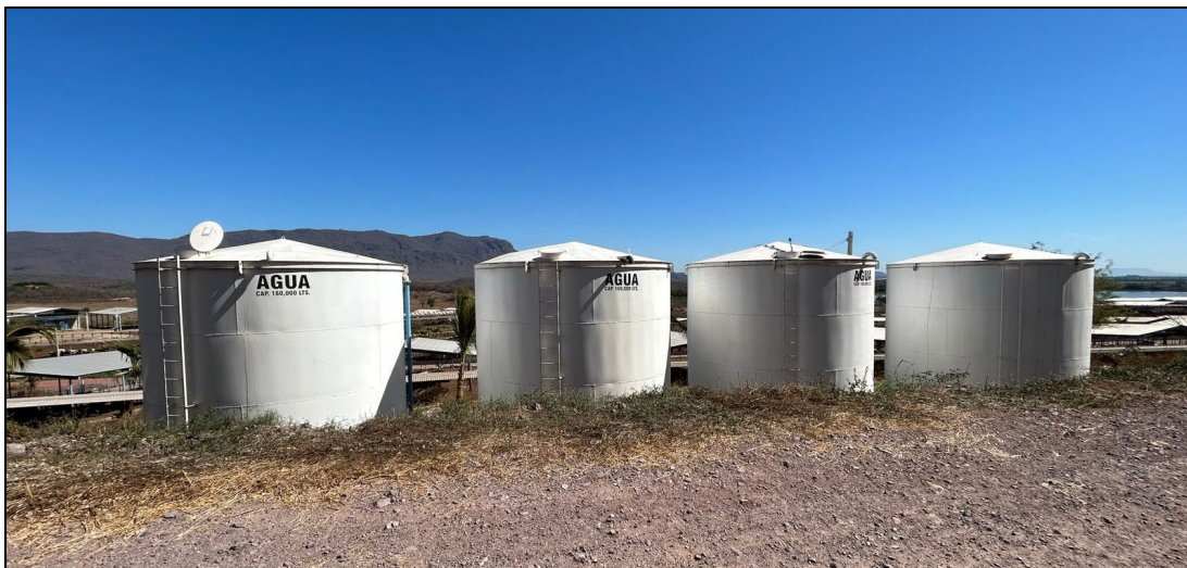
Figura 14. Tanques de agua con capacidad de 260,000 L.
